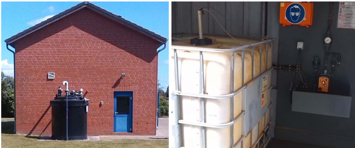
Abbildung 3-11: links: Tanklösung, Dosieranlage ist im Inneren des Betriebsgebäudes untergebracht rechts: eingebaute Dosierstation mit stationärem IBC-Container und Dosierpumpe
