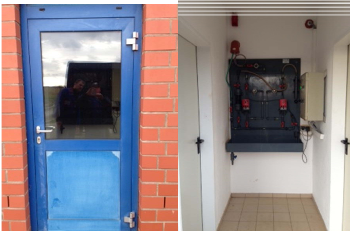
Abbildung 4-2: Frostsichere Anordnung der Dosierstation im Betriebsgebäude einer Kompaktkläranlage; der Fällmitteltank befindet sich neben dem Gebäude
