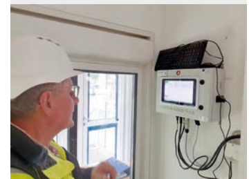
Anzeigeeinheit einer Portalmeßanlage
