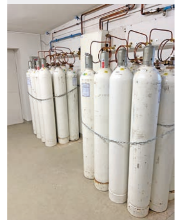
Flaschenbatterie mit Sauerstoffflaschen mit Anbindung an das Leitungsnetz des Krankenhauses
