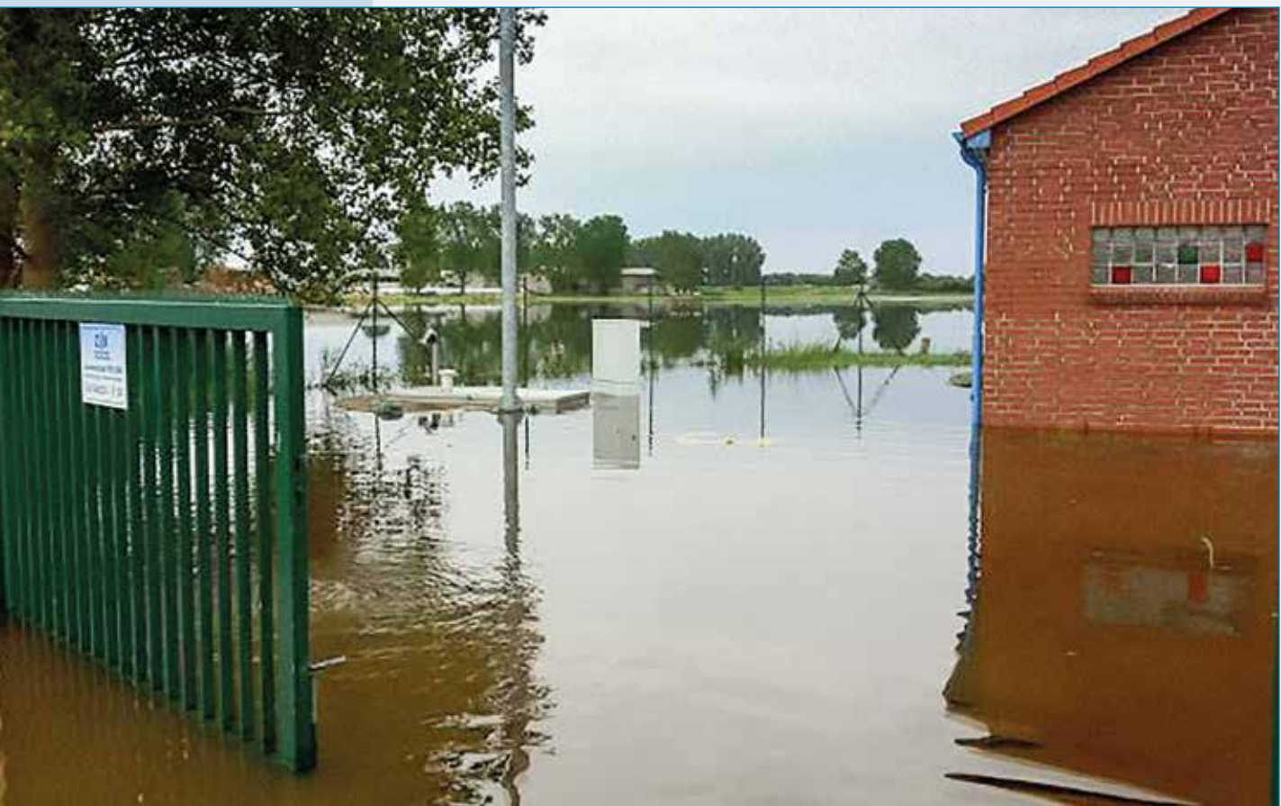
Abwasserpumpwerk Rethwisch während der Überflutungen im Sommer 2011 | Foto ZVK
