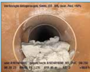
Ablagerungen in einem Kanal Foto: ZVK
