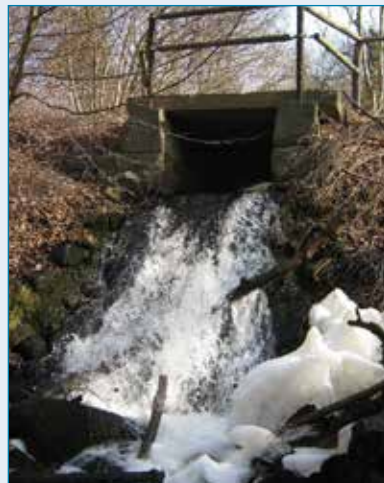
vor der Maßnahme: Sohlabsturz am Auslauf des Tribohmer Teiches, Foto: Umwelt Plan GmbH Stralsund
