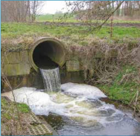
nicht durchwanderbarer Durchlass mit Sohlabsturz am Damshäger Bach; Foto: Pöyry ibs 2009
