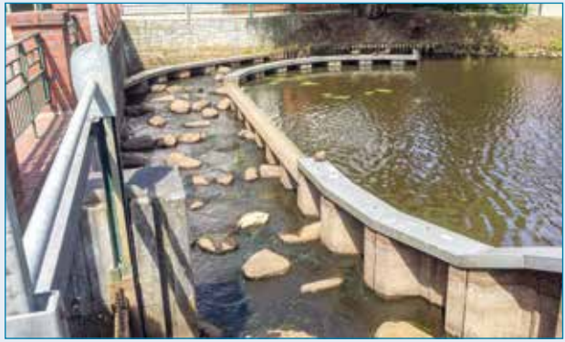
Fischaufstiegsanlage am Mühlenteich, Foto: StALU WM
