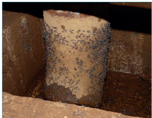
Abbildung 10: Reinwasserbehälter, Mücken am Auslauf eines Überlaufes (26)
