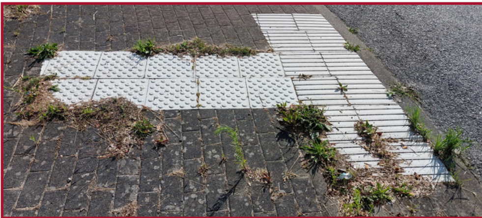
Abb. II 42 – eingeschränkte Nutzbarkeit von Bodenindikatoren durch fehlende Unterhaltung
