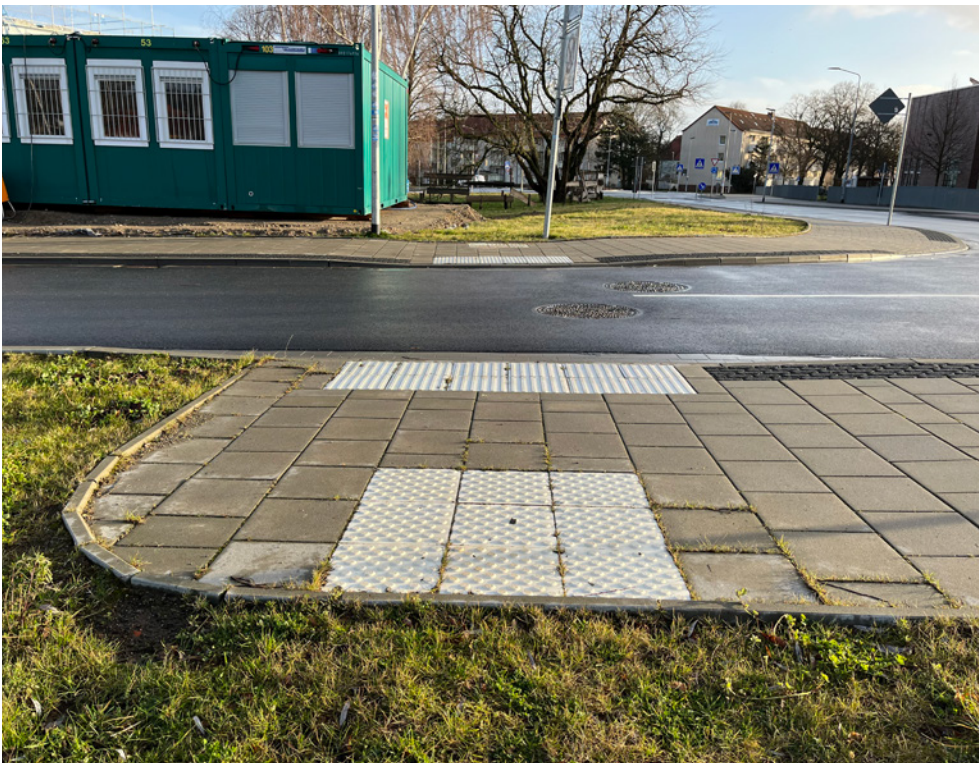
Abb. V 25 – ungesicherte Querung einer Erschließungsstraße
