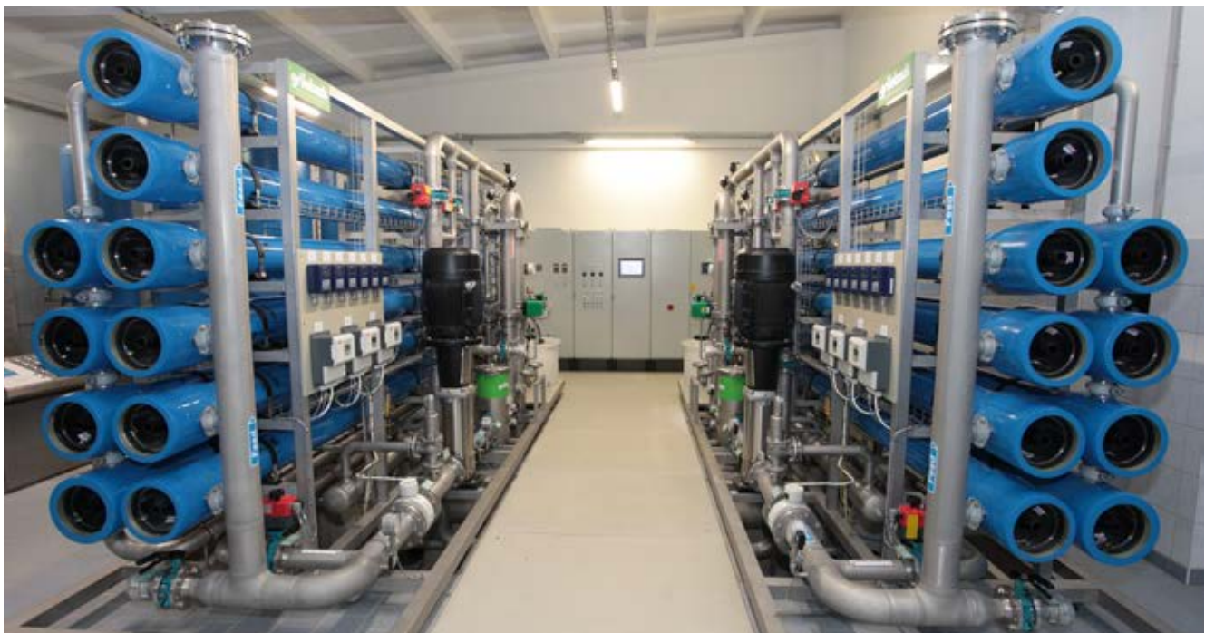
Abbildung 3: Umkehrosmoseanlage im Wasserwerk Lüssow
