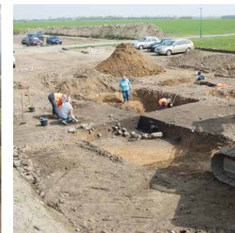
li.: Leitungstrasse bei Pelsin, Lkr. Vorpommern-Greifswald © LAKD M-V/BD, Detlef Jantzen
